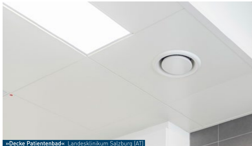
»Decke Patientenbad« Landeskrankenhaus Salzburg (AT)
